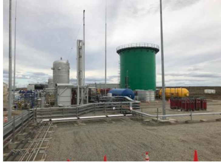
Tanque de almacenamiento
