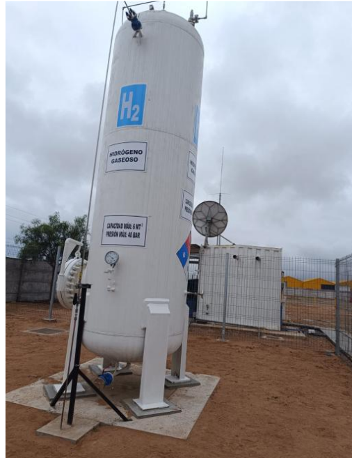
Estanque de almacenamiento
