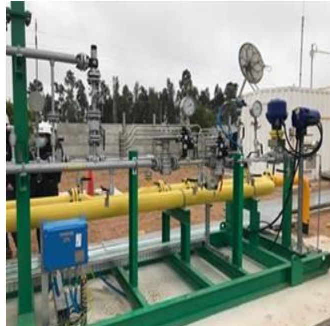
Mezclador de gas natural e hidrógeno
