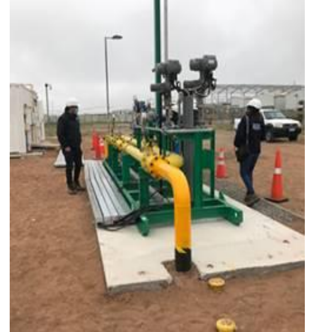
Tubería inyección de mezcla a la red
